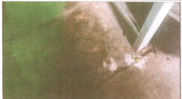
Foto 2: Estado actual del piso de la cocina.
